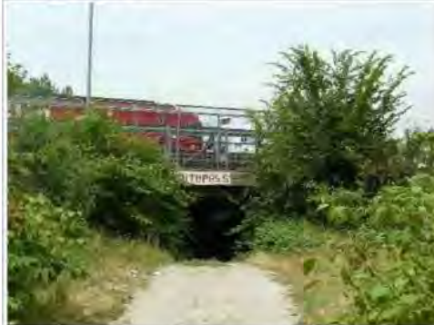
Sottopasso di via Momera all'altezza della A4 completamente allagato in caso di esondazione del Lambro
