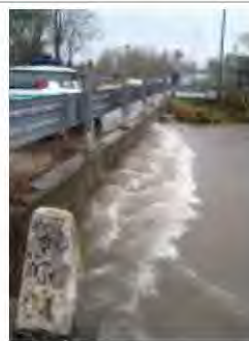
Ponte di S. Maurizio al Lambro durante l'evento alluvionale del 2014 [foto Comune di Cologno Monzese]
