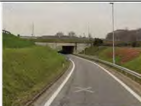
Sottopasso in corrispondenza dello svincolo autostradale A4/A52 nei pressi della barriera e potenzialmente soggetto ad allagamento a seguito dell'esondazione del Lambro [foto Google Street View]
