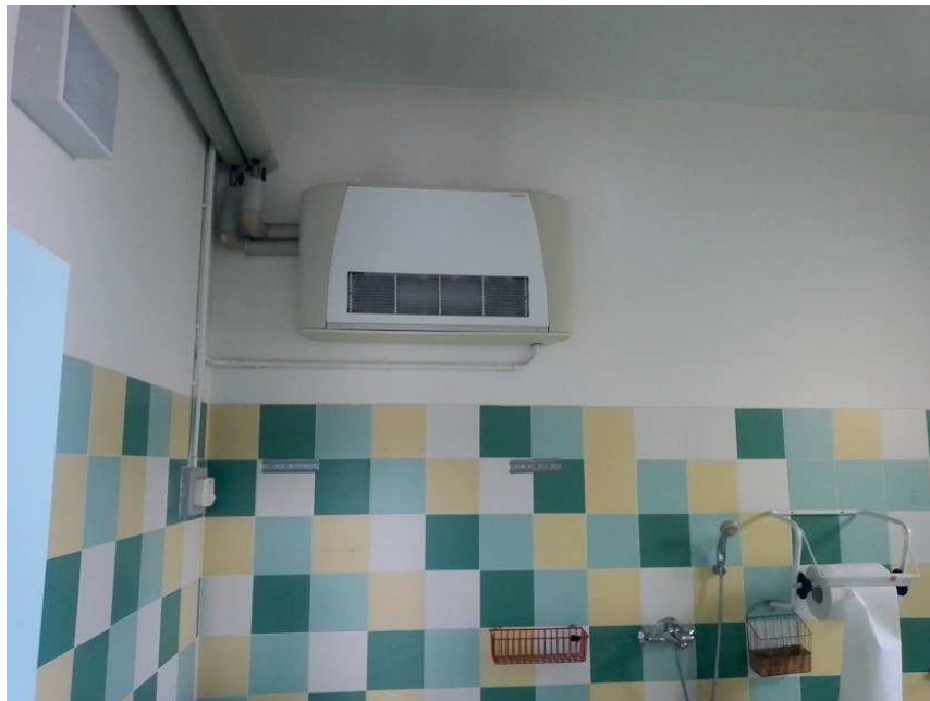
Immagine 11: Sistema di riscaldamento da efficientare
