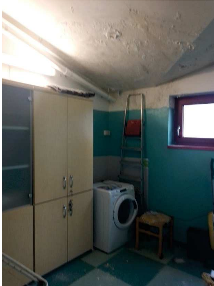
Immagine 10: Lavanderia da sanificare
